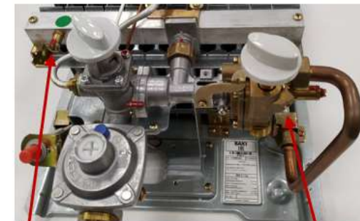
Замер давления газа на горелке
